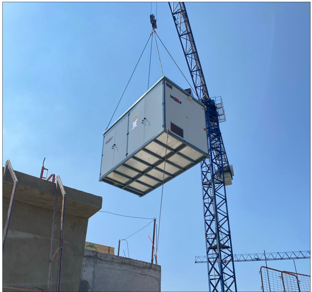
Una grúa de 40 metros se utilizó para alzar las dos toneladas de la sala de caldera.
